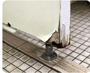
清掃で水がかり腐食が進んだ従来の化粧合板
